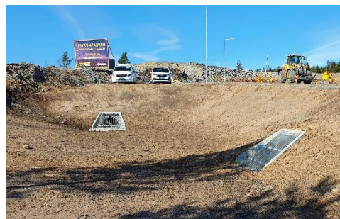
Fordrøyningsbasseng Fiskum. Foto: Øyvind B. Johnsen
